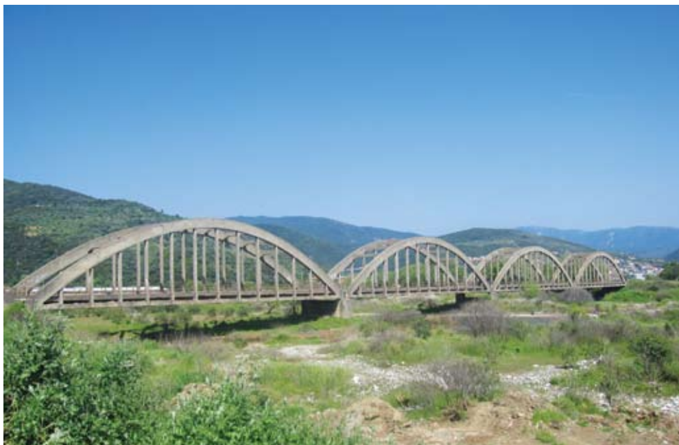
Από το 1937 έχει να επισκευαστεί η ιστορική Γέφυρα του Μόρνου
